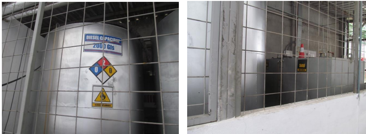
Ilustración 29. Tanques de almacenamiento de diésel
